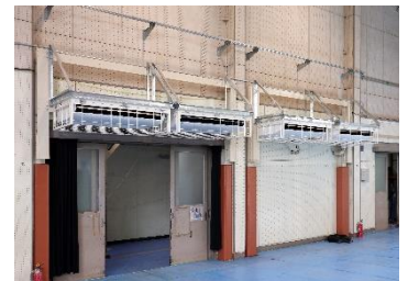
エアコンが設置された体育館
